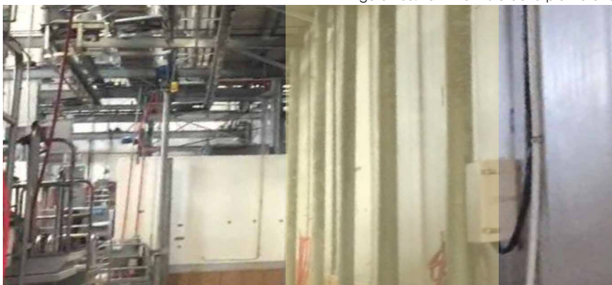
Figura 264: Estructura de las naves de producción
