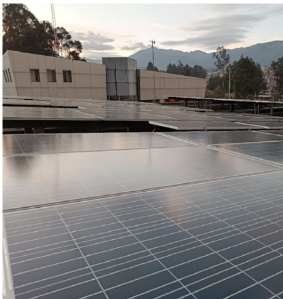
Paneles fotovoltaicos que proveen energía limpia al aula. Crédito: Micro-Red.
