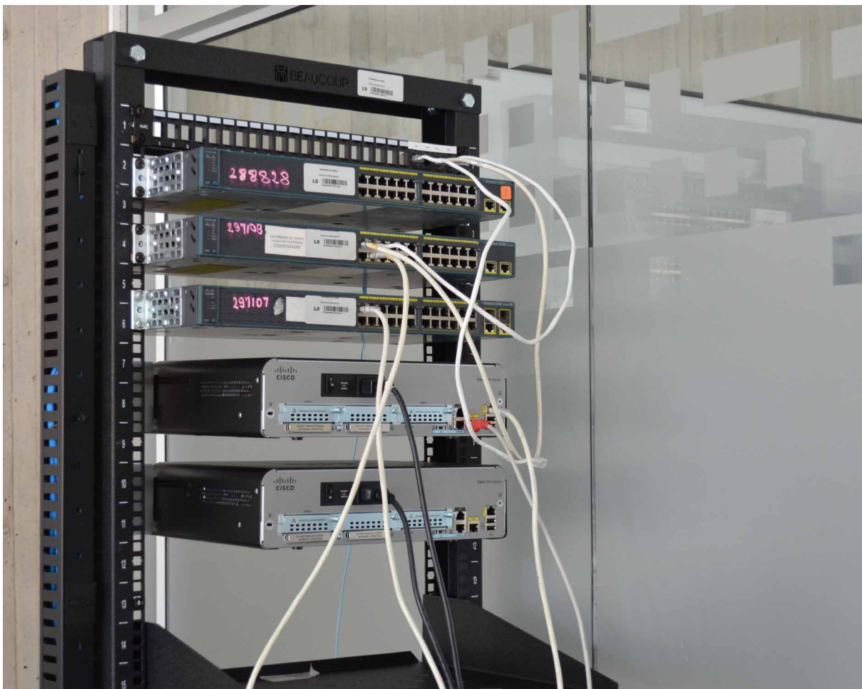
Rack de telecomunicaciones
