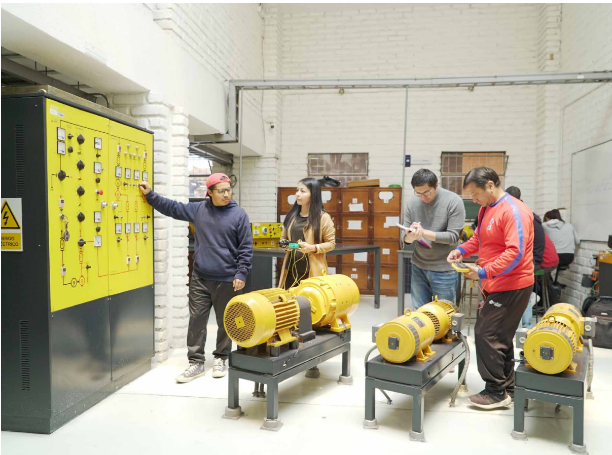
Actividades en el tablero de transferencia del Laboratorio de Máquinas
